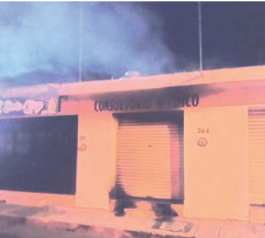
Foto de Sergio Uribe El incendio de una zapatería en la cabecera municipal de Cuauhtémoc dejó cuantiosos daños materiales.
