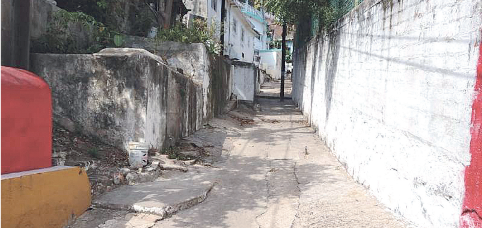
Con manchas en las paredes y pisos dañados lucen los andadores del Sector II, en el centro de Manzanillo, por lo que habitantes del lugar exigen mantenimiento a la zona.
