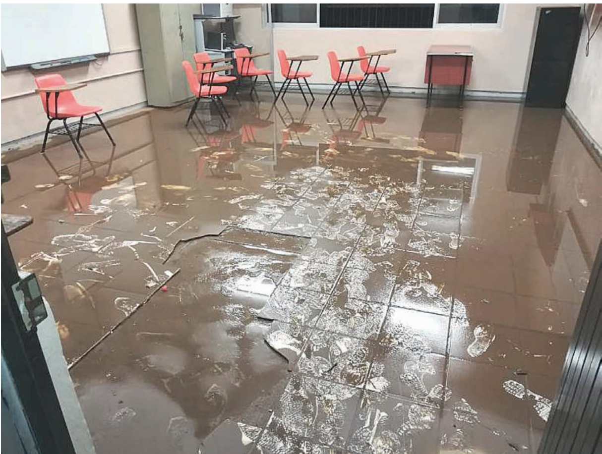
Foto de Osiris Moreno Algunos salones de la telesecundaria de El Naranjo se inundaron, por lo que los padres de familias piden la construcción de un muro de protección al inmueble.
