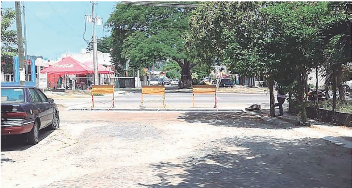
Osiris Moreno Sigue cerrada la avenida Arrecifes, calle donde la CAPDAM realiza una obra, pero hace 2 meses la abandonó, dejando sólo unos señalamientos que impiden el paso a los automovilistas.
