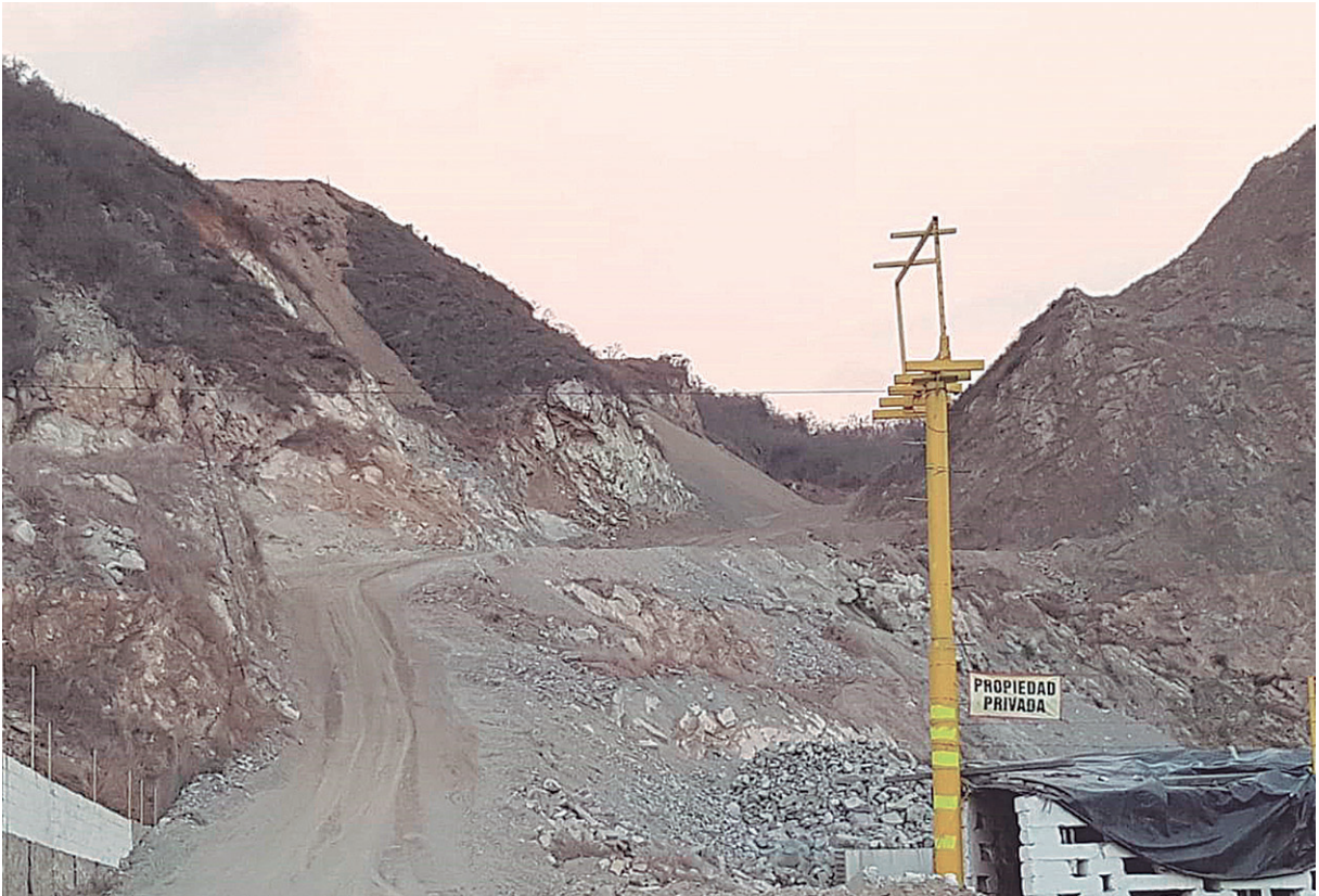
Foto de Julio González El Ayuntamiento de Manzanillo clausuró un banco de materiales en la colonia San Carlos, en la delegación Tapeixtles, que ponía en riesgo la seguridad de cientos de familias
