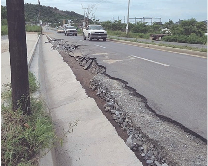
Foto de Osiris Moreno La Secretaría de Infraestructura y Desarrollo Urbano anunció que harán una base de concreto para evitar que el agua se introduzca por debajo de la cinta asfáltica, en la carretera a Chandiablo, y evitar que se levante la carpeta.
