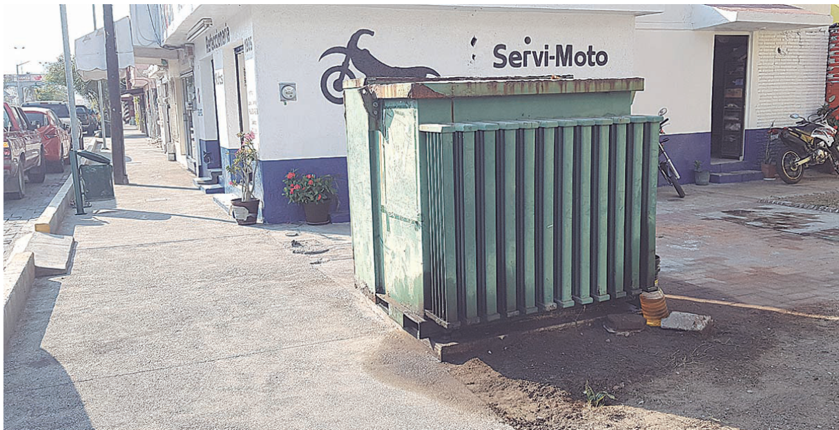
Foto de Julio González Vecinos de la colonia Infonavit denuncian que este transformador de la Comisión Federal de Electricidad (CFE) pone en riesgo la salud de miles de familias.
