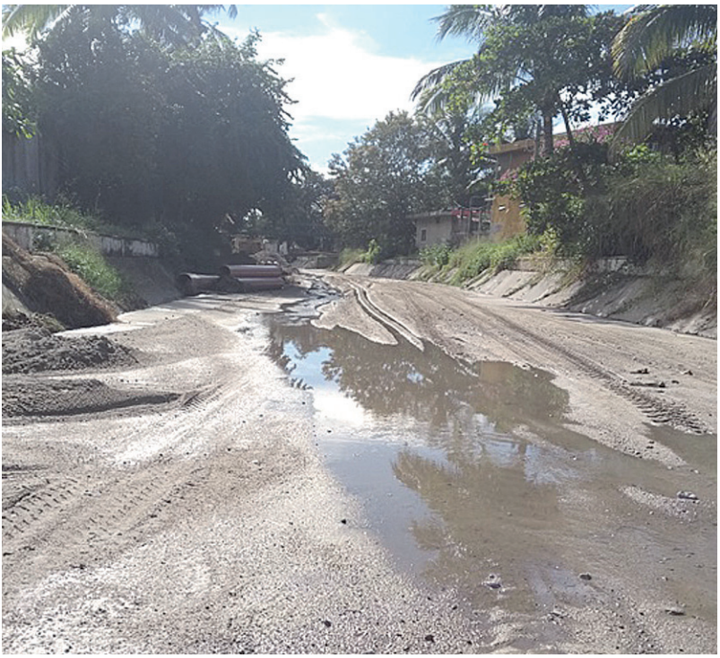
Foto de Osiris Moreno Apenas el 30 por ciento de sus niveles de capacidad registraron los arroyos del municipio, tras las lluvias registradas la noche del miércoles 1 de enero. En la imagen, el cauce del Arroyo Santiago, mismo que luce con encharcamientos y lodo.
