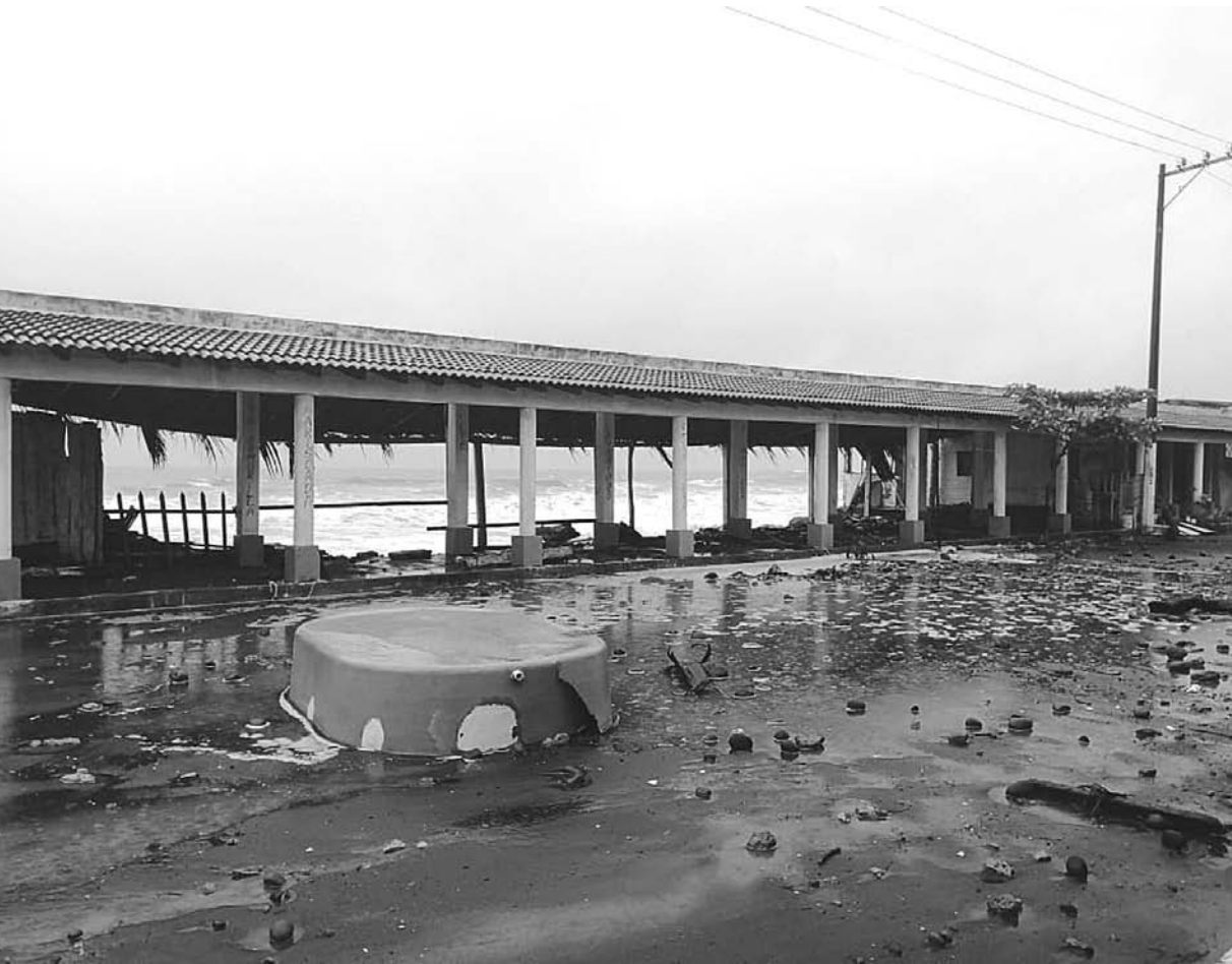
Aspecto de los daños ocasionados por las marejadas que dejó a su paso la tormenta tropical Hernán , en El Paraíso.
