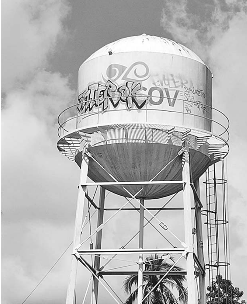
Foto de Efraín Medina VANDALISMO En varios puntos de la ciudad de Colima hay tanques de agua de Ciapacov con pintas, como se aprecia en la imagen, en prolongación Anastasio Brizuela.
