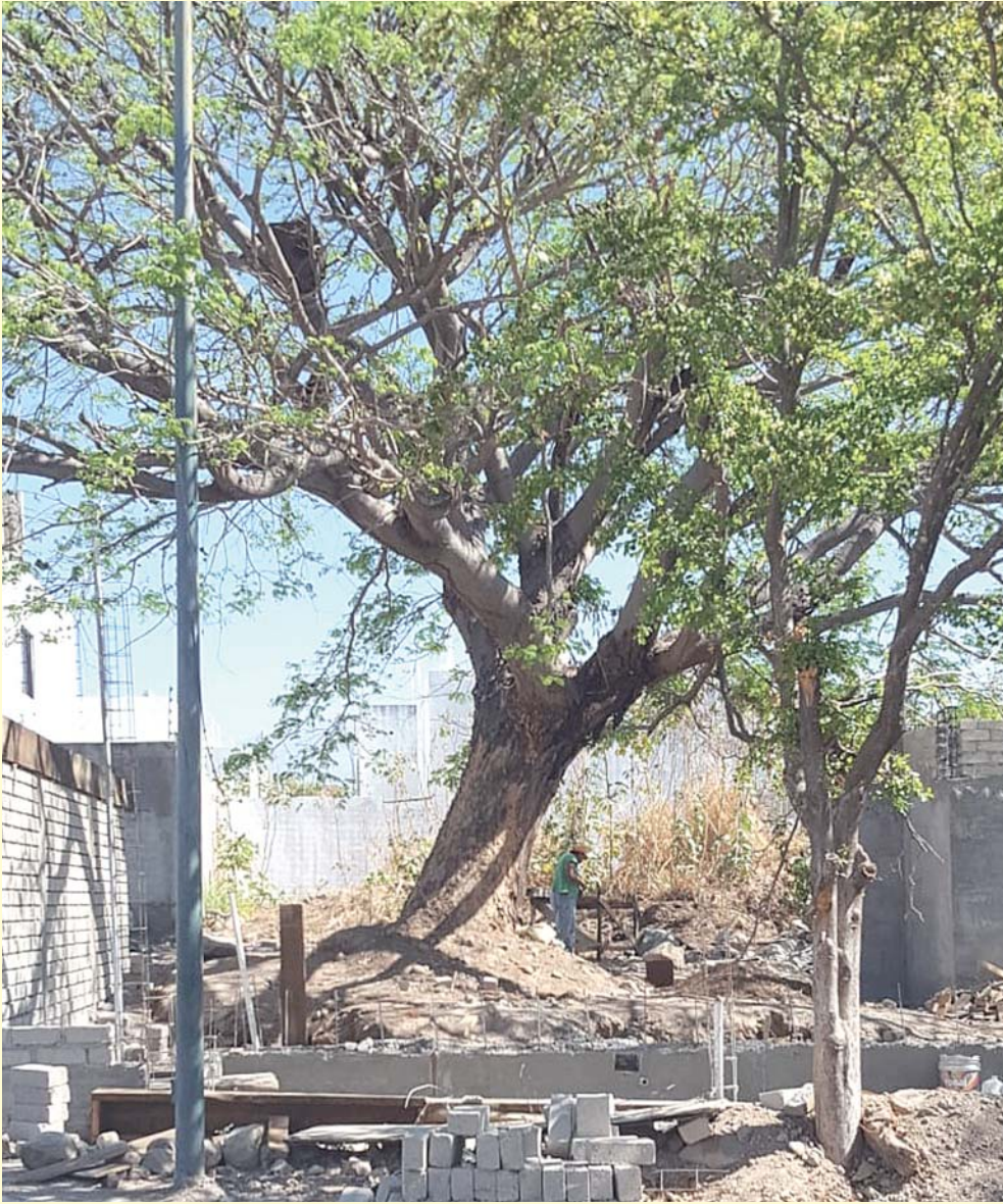
Foto Cortesía El Ayuntamiento de Villa de Álvarez suspendió las obras en un predio de la colonia Las Colinas, por los probables daños a una parota y por carecer de permiso de construcción.
