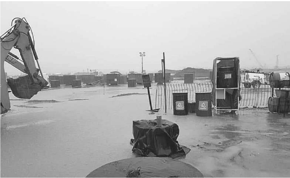
Foto Internet Tras fuertes lluvias del domingo, ayer por la mañana, el sitio de construcción de la refinería en Dos Bocas, Tabasco, amaneció inundada.
