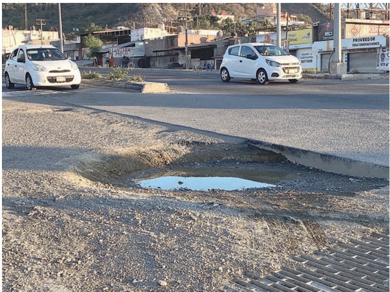
Foto de César González La obra de acceso a Manzanillo luce destruida, y conductores piden a las autoridades que la terminen cuanto antes, dado el riesgo que representa a la seguridad.
