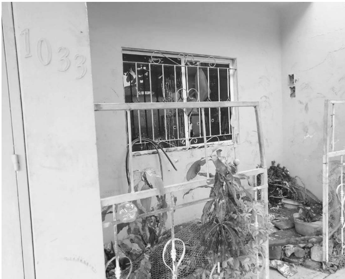
La fachada de una vivienda en la calle Hacienda de San Antonio de la colonia Francisco Villa, fue baleada ayer por la tarde.
