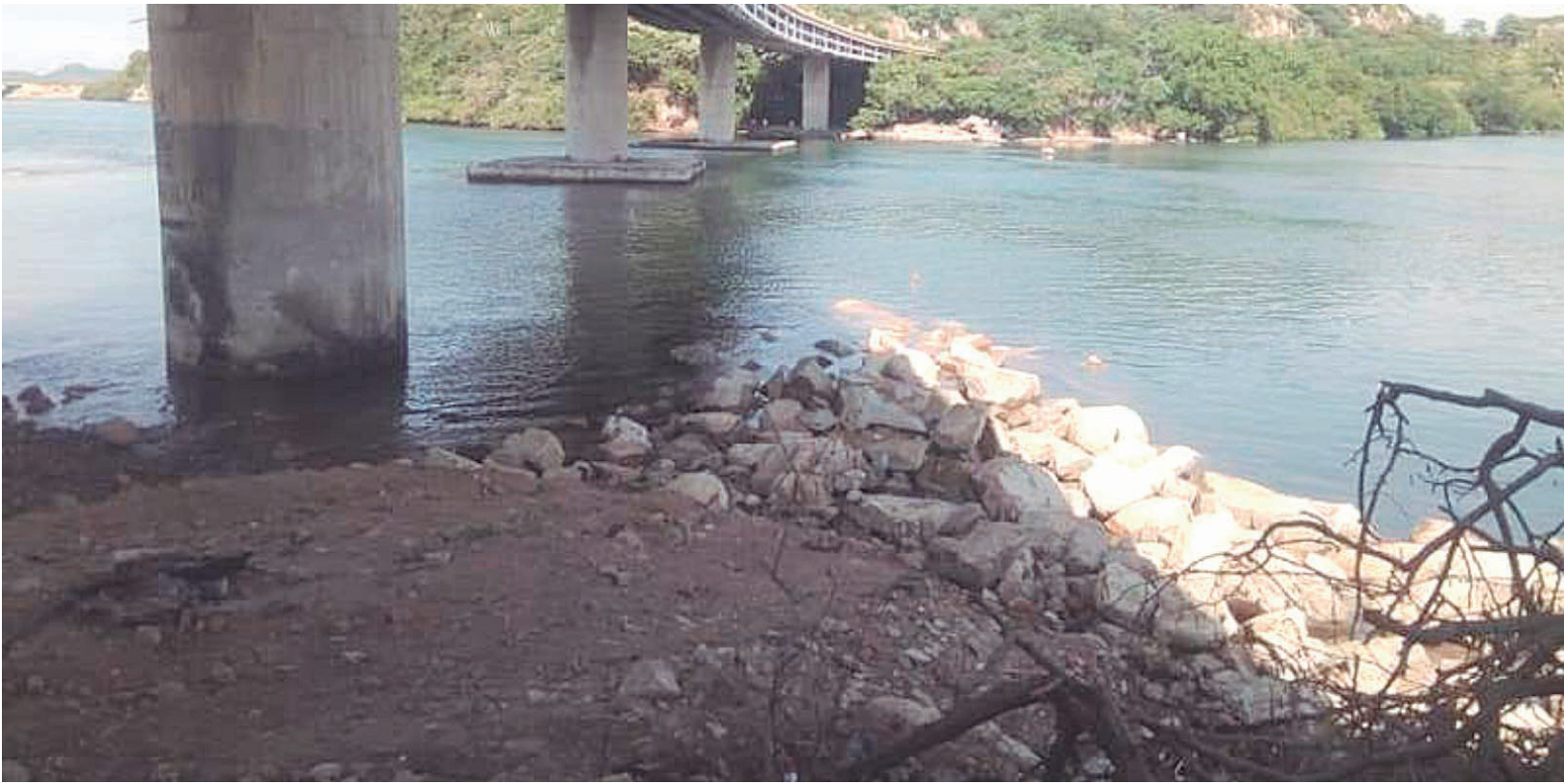
Foto de Osiris Moreno Pescadores demandarán ante la Profepa a Pinfra, encargada de la ampliación del puente de Tepalcates, por causar daños a la laguna de Cuyutlán con escombros arrojados debajo de ese paso. En esta imagen se ve el material tirado en el vaso lacustre.
