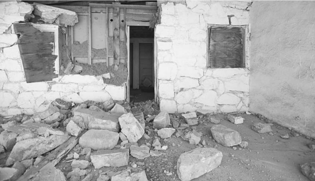
Foto Internet Evalúan daños por sismo de magnitud 7.1 en California que remeció la región desde Sacramento hasta México.
