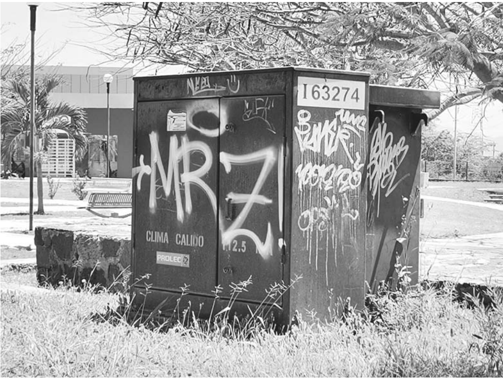
Foto de Efraín Medina VANDALISMO El Parque de la Piedra Lisa se ha convertido en un lugar preferido por los vándalos, quienes realizan pintas, como se aprecia en este transformador.
