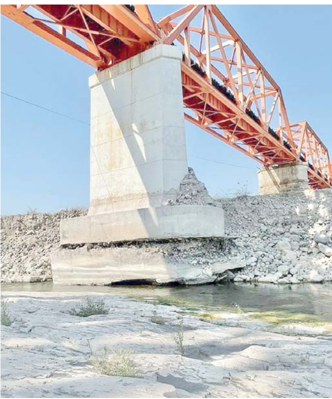
Foto de Luis Rosales Habitantes de la comunidad de Santa Rosa se muestran preocupados por el visible daño en el puente del ferrocarril.
