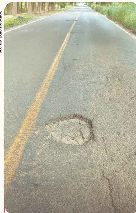
La carretera Caleras-Madrid presenta deterioro y requiere mantenimiento.
