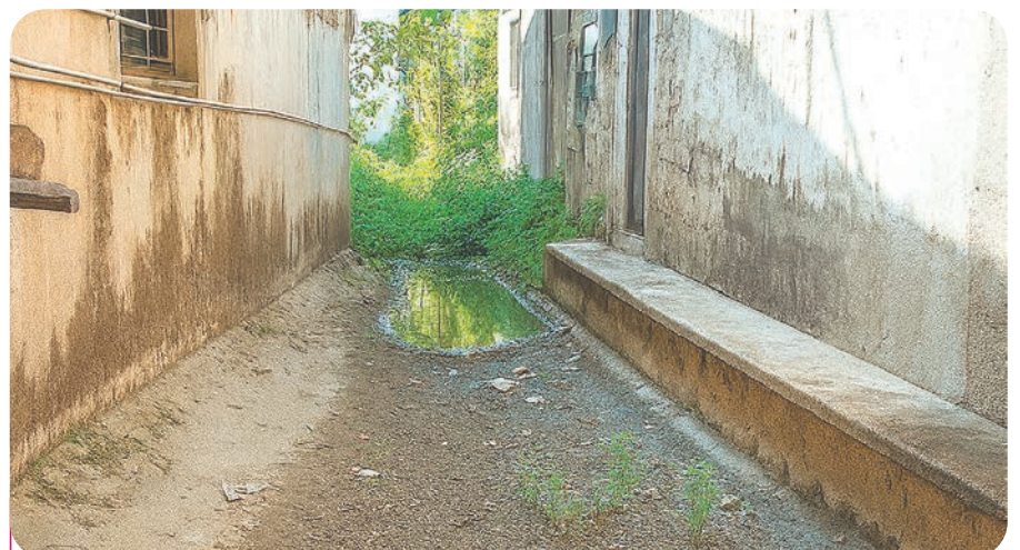
A pesar de que ya se realizó el reporte, la CAPDAM no ha reparado la fuga de aguas negras.
