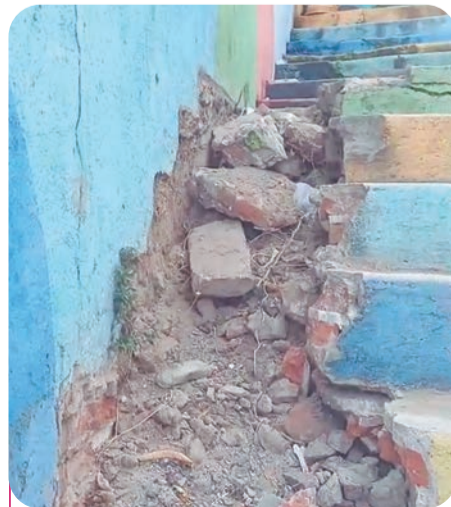
Hace 2 meses, tras reparar una fuga, personal de la CAPDAM se fue del lugar sin tapar el pozo que hicieron.
