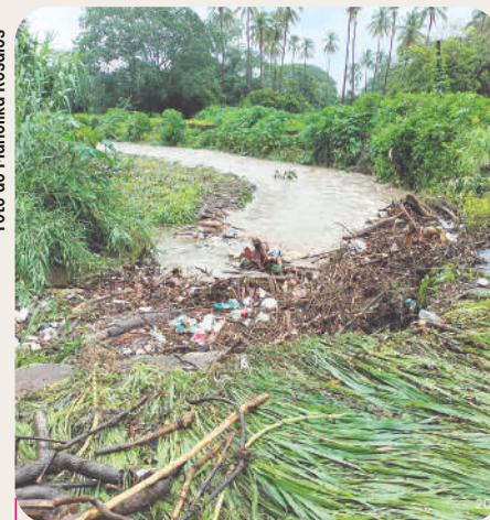
En Coquimatlán se interrumpió el paso a la comunidad de Jala, debido al taponamiento del puente del arroyo Los Limones, a consecuencia de la acumulación de basura.
