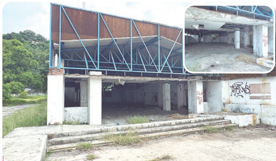
Vecinos de San Pedrito denunciaron que la antigua farmacia y tienda comercial del ISSSTE representan un riesgo para la seguridad.
