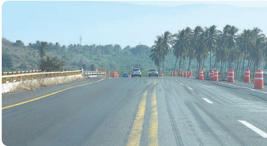
Desniveles y topes improvisados generan riesgo para conductores en el puente del río Armería.
