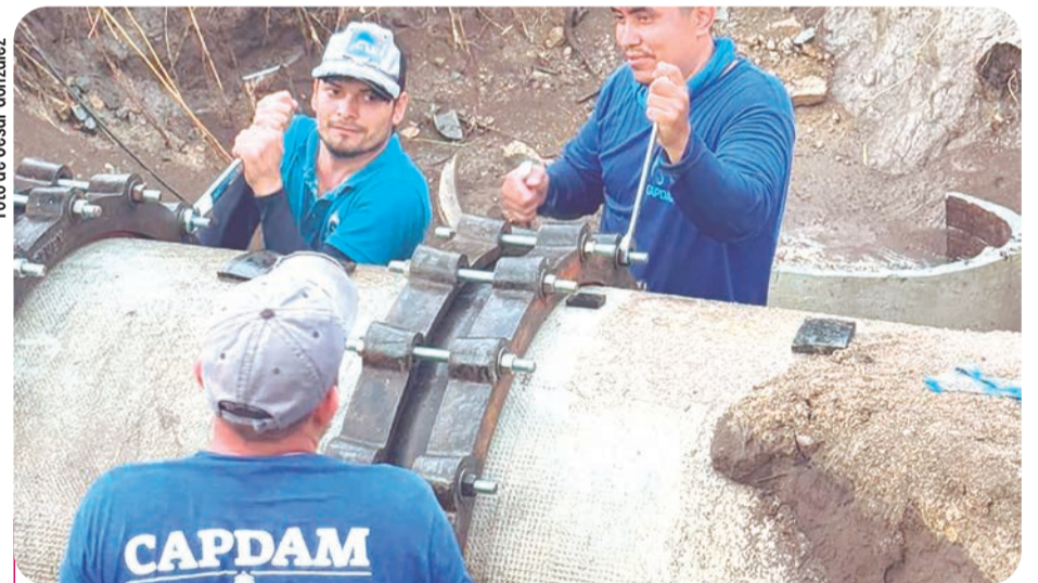
Foto de César González La CAPDAM señaló que una constructora dañó la línea principal de agua.
