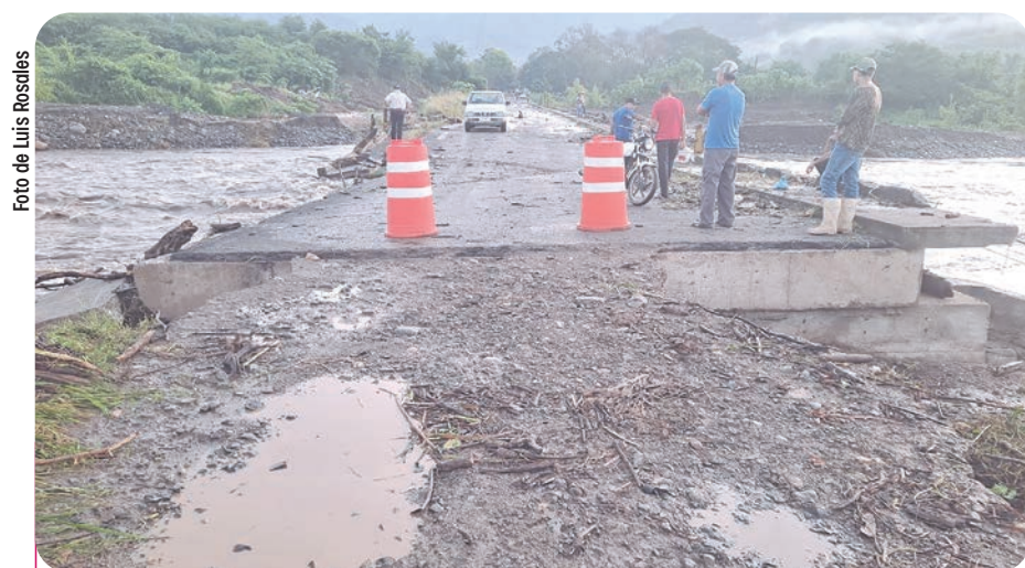
En el lugar se originó un socavón de alrededor de 30 metros.
