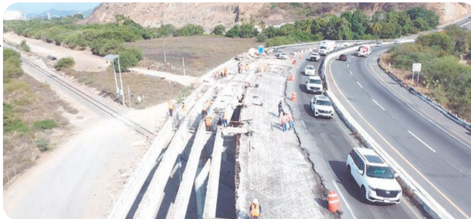
La ampliación a seis carriles permitirá mejorar la circulación y disminuir la saturación vehicular provocada por el transporte de carga.
